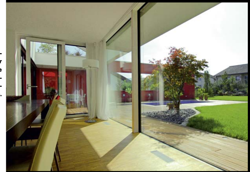
|| Im Erker des Essbereichs: am Boden vor den „Fenstern“ sind die Auslässe der Lüftung beziehungsweise Lüftungsheizung zu erkennen.
