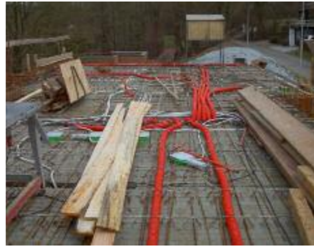
|| Vor dem Betonieren der Decke und des Dachs wurden die Kanäle der Lüftungsanlage zwischen die Bewehrung gelegt. Silke und Albert Staacke
